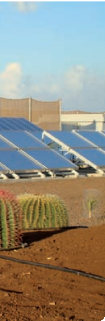
Viele entlegene Gebiete mit Wassermangel haben drei Dinge häufig im Überfluss: Sonne, Wind und Meer. Aufbau einer solarbetriebenen Wasserentsalzungsanlage in Gran Canaria. © Fraunhofer ISE
